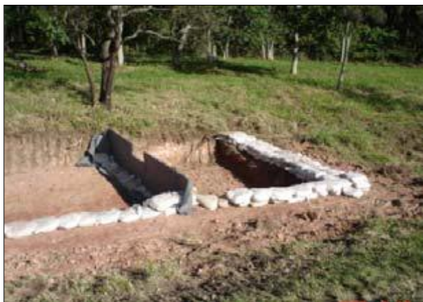
Foto 10.2.6-4: Barreiras em bacia de contenção.
